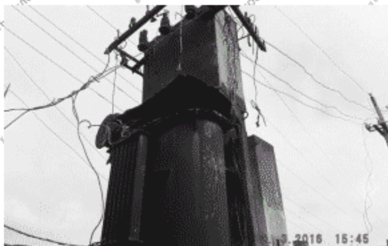
Рисунок 2 – Сгоревшая трансформаторная подстанция в с. Глыбочки Орловской области
